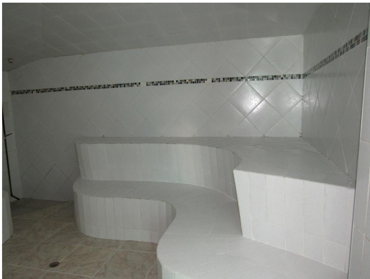
Cámara de Vapor
